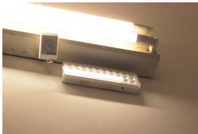
Figura 3 - Instalação de sensores de presença. Foto: Jonatas Oliveira
