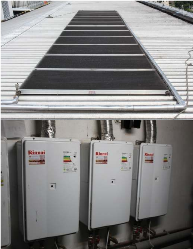
Figura 5 - Instalação do Sistema de Aquecimento Híbrido. Fotos: Jonatas Oliveira
